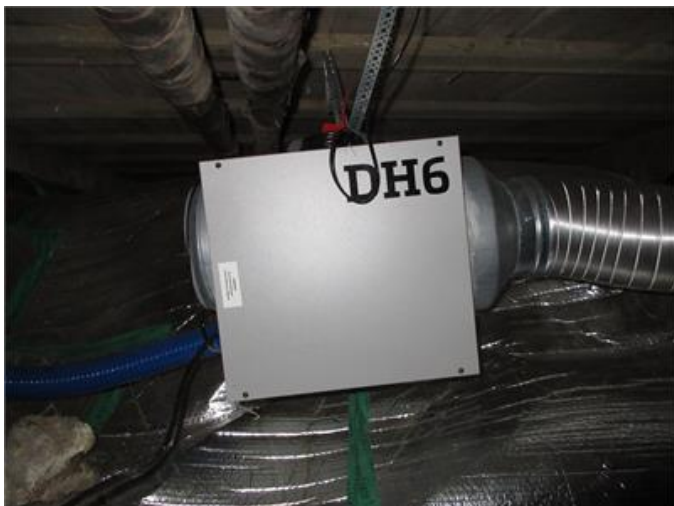
Avfuktare/fläkt i grund
