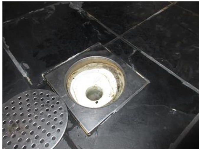
Klämring saknas i golvbrunn och brunnsmanschett har släppt
