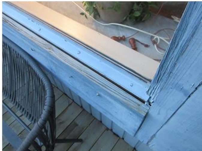
Exempel på brister i fönsterfoder/bleck
