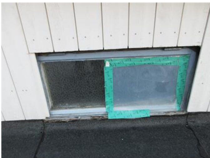
Exempel på brister i fönsterfoder/bleck
