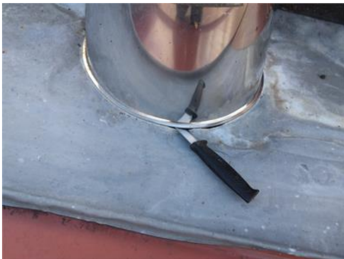
Otättheter runt skorstensrör
