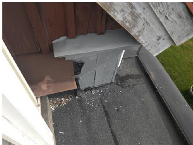
Brister vid uppvik takpapp på garage
