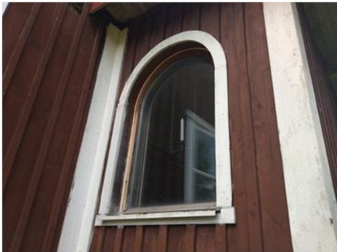
Bild visar exempel på fönster med underhåll
