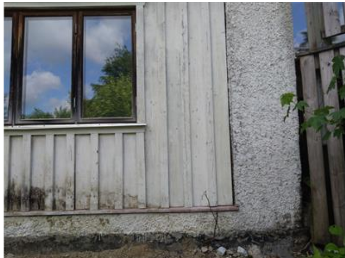
Glipor i anslutning mellan fasadpanel och sockel samt röta i fasad
