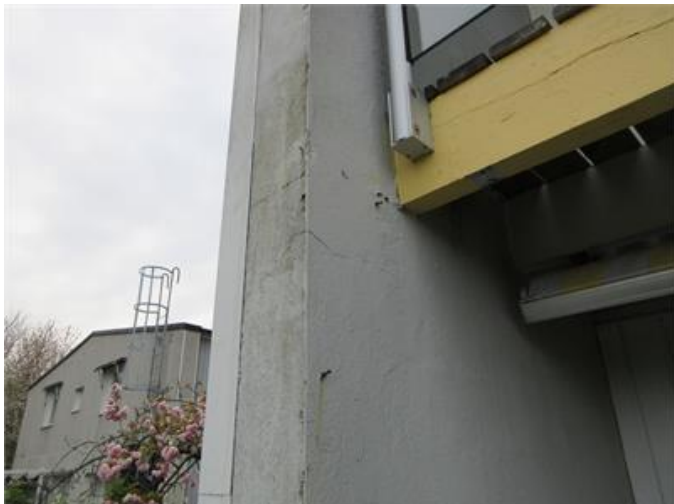
Sprickor i betongvägg
