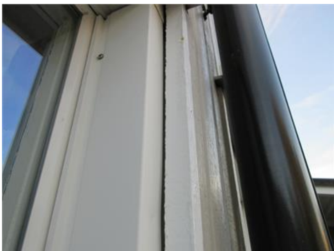
Glipor mellan fönsterkarm och fönsterfoder
