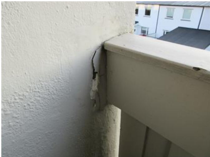
Sprickor i betongvägg vid infästning av balkongräcke
