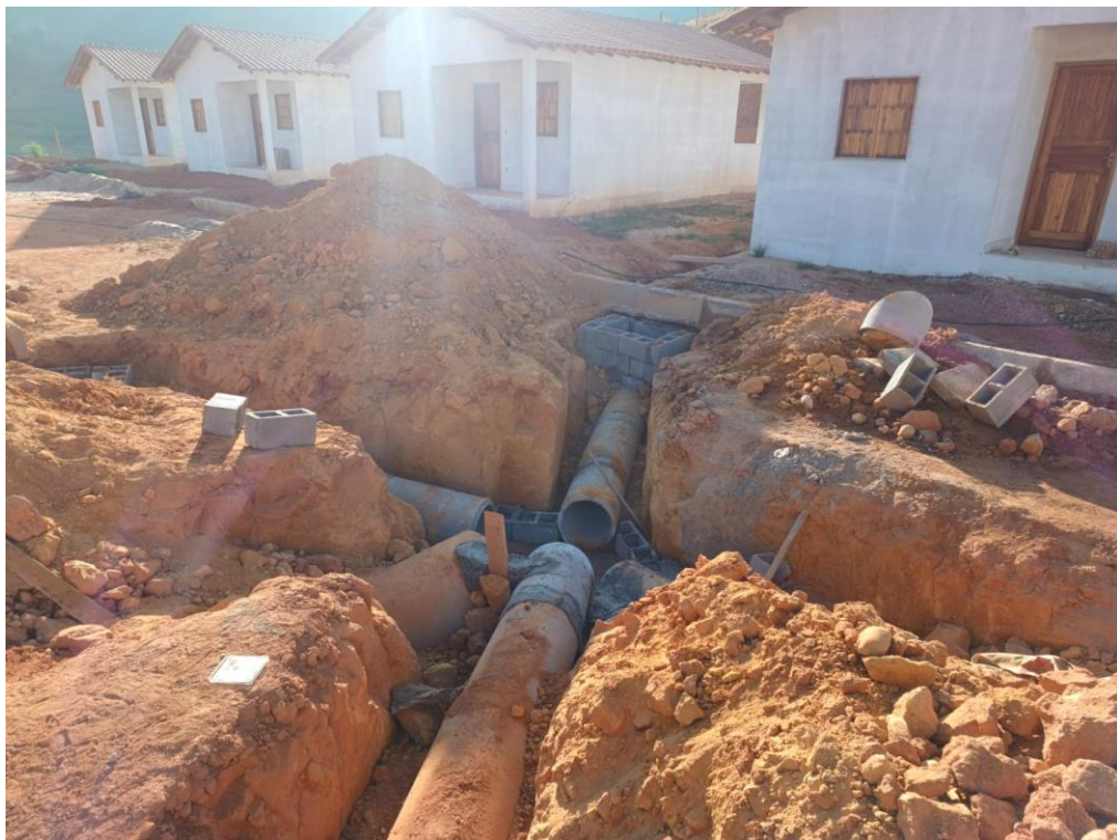
Figura 2- Instalação de Tubo de concreto para drenagem profunda no encontro da Rua 01 com a Rua 03. Execução de caixa de bloco de concreto para instalação de Boca de Lobo (BL).
