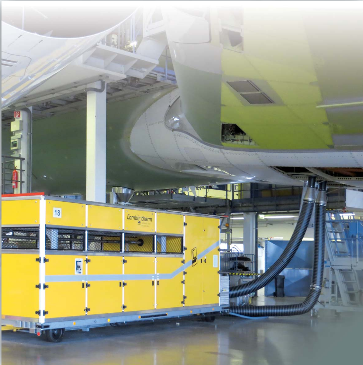
ANSOR kühlt und heizt Airbus A380
