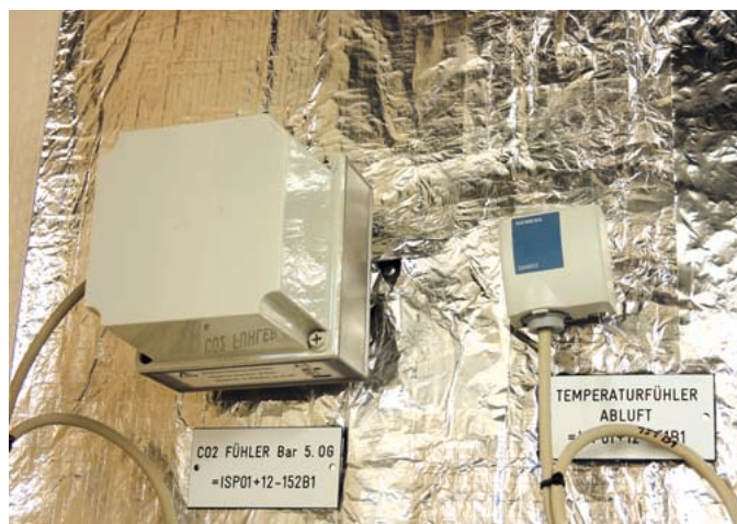
CO 2 -Fühler im Abluftkanal der Küche
