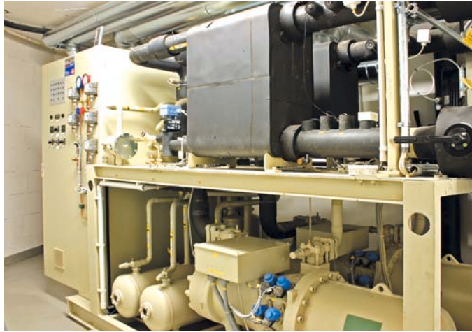
Rund 65 % der Jahresheizarbeit sowie etwa 30 % der Jahreskühlarbeit wird über die Grundwasser-Wärmepumpe erbracht
