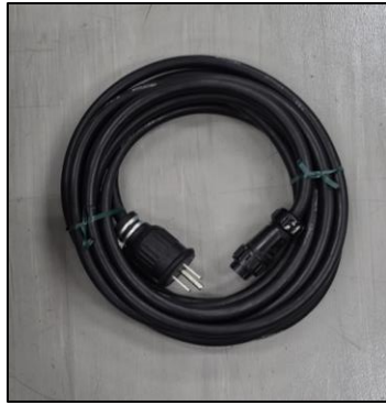
主電源ケーブル
