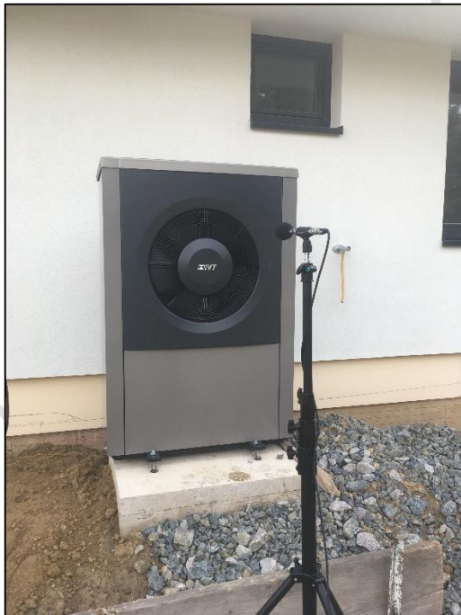
Obr. 3 Pohled na TČ a měřicí místo M1
