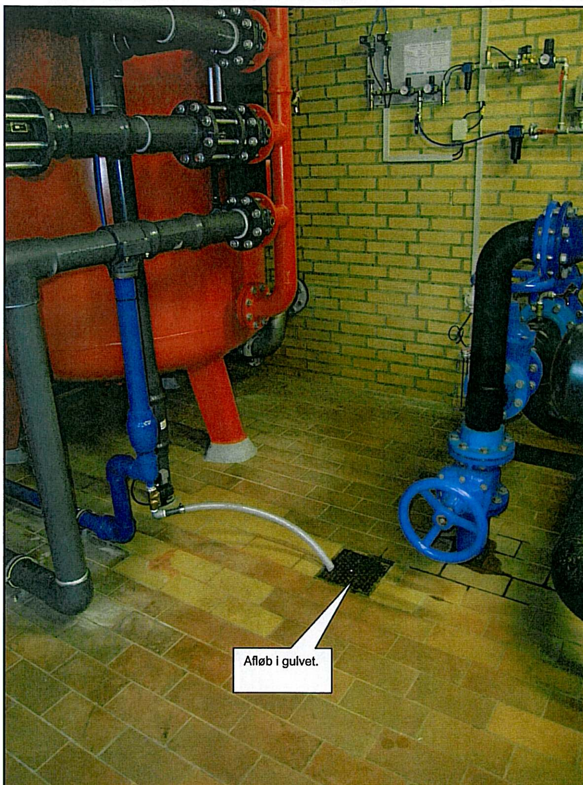
Fig. 17: Afløb i gulvet er tilkoblet regnvandsledning.
