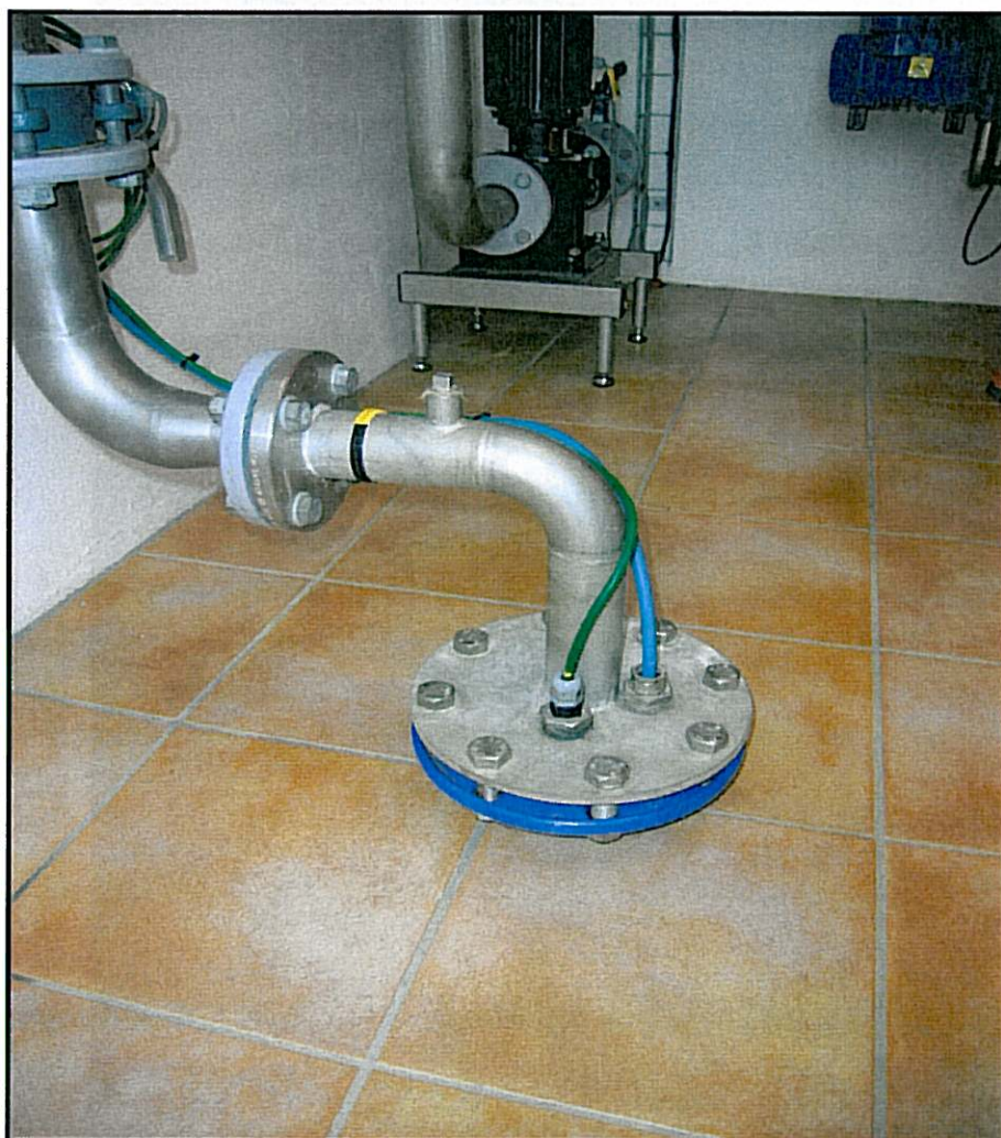
Fig. 6: Boring 42.047/Smeden er placeret i vandværksbygningen.
