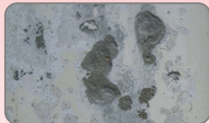
水泥砂漿層粉化長毛輕易撥就有坑洞
