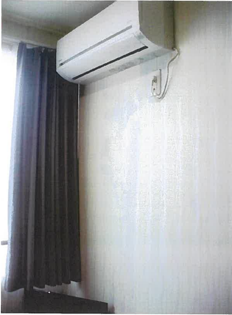
208 号室の東側の壁のカビのような汚れ
