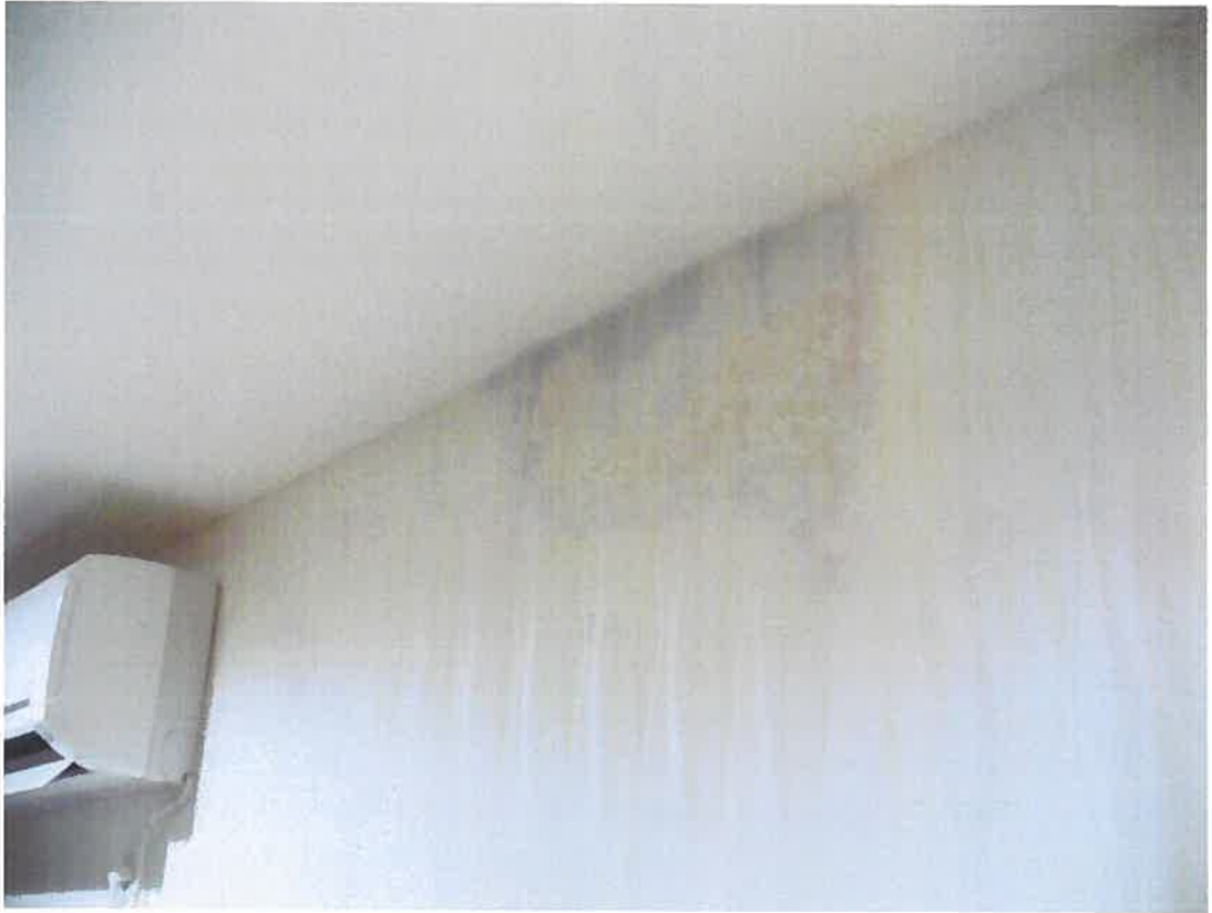
108 号室の東側の壁の上部のカビのような汚れ
