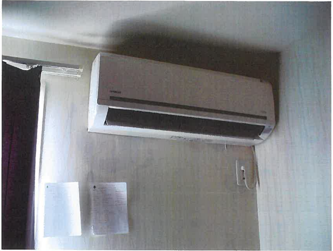
207 号室の北側の壁のカビのような汚れ
