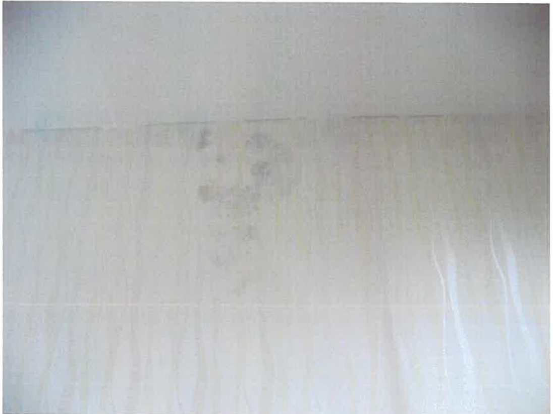
208 号室の東側の壁の上部のカビのような汚れ
