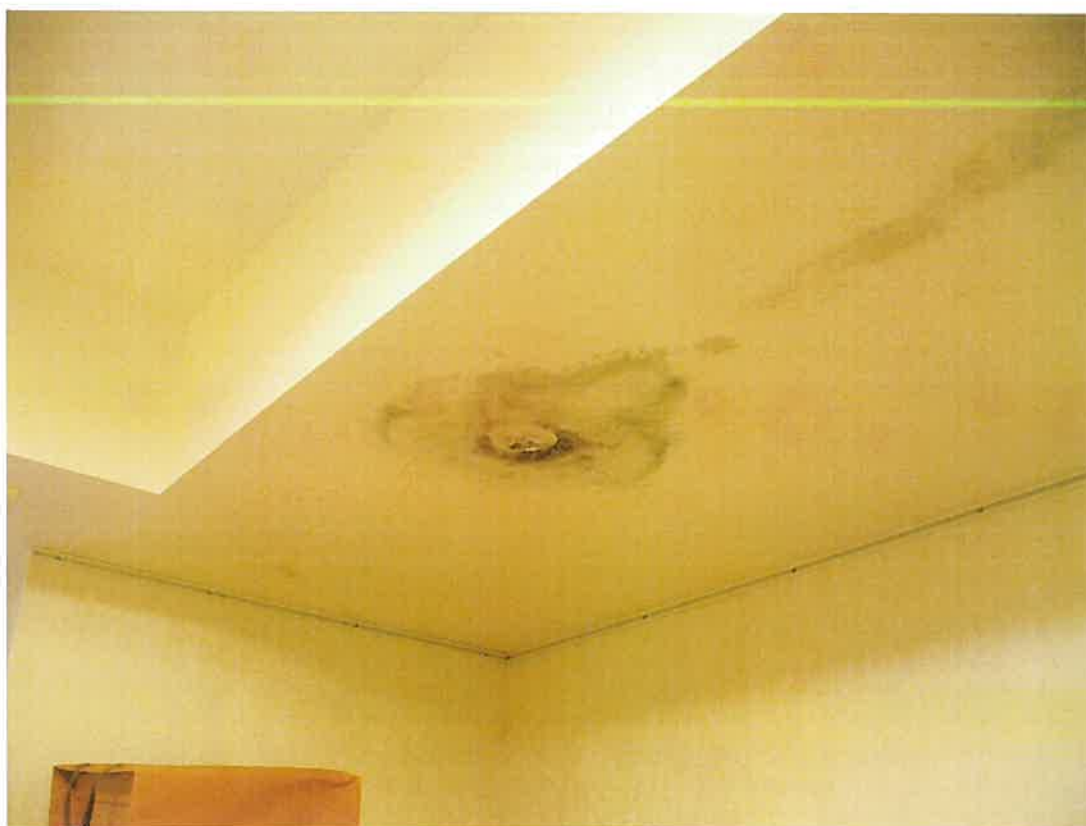
上記廊下の天井部分の北方に位置する洋室の天井部分のカビ (0.5 m程度の円状)
