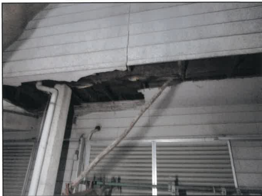
⑫ 物件4建物内の状況ーバルコニー下部の損傷部分
