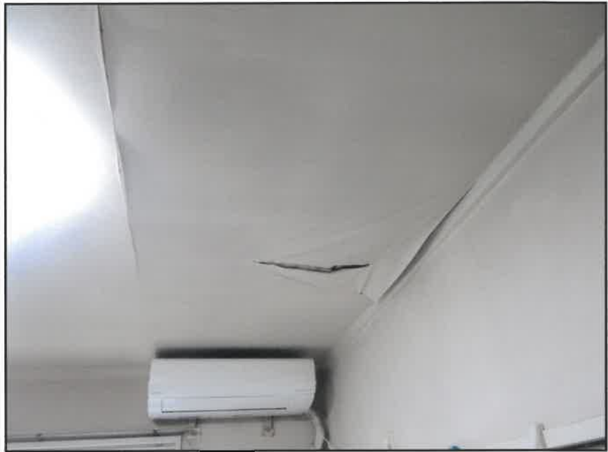
⑪ 物件3建物内の状況－205号室:和室2の天井部分
