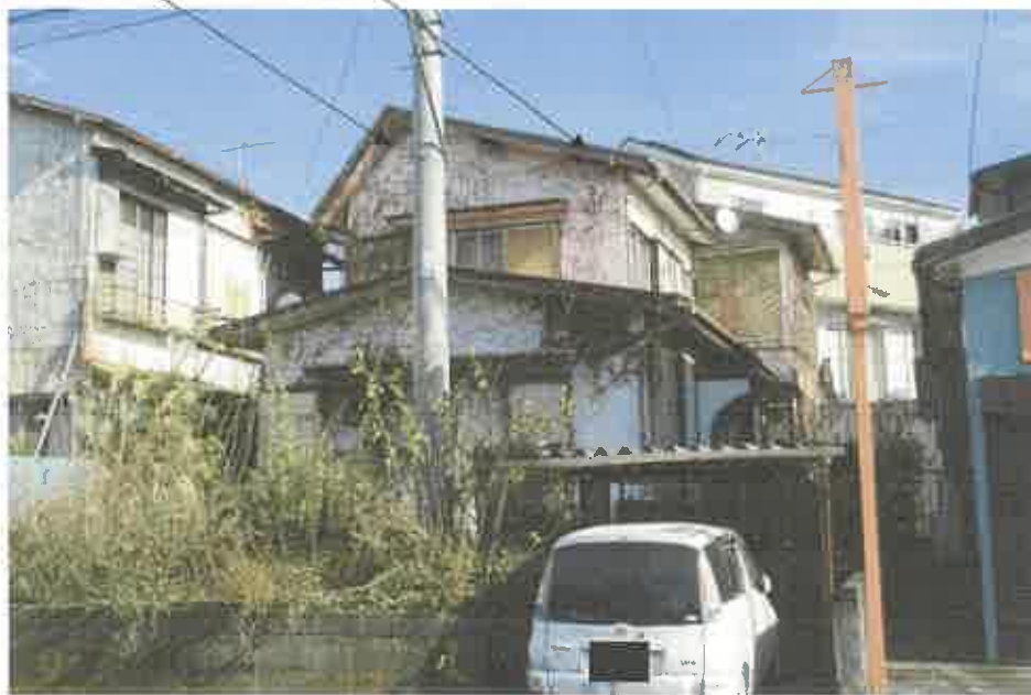
① 本土地上の電柱 軒下の破損
