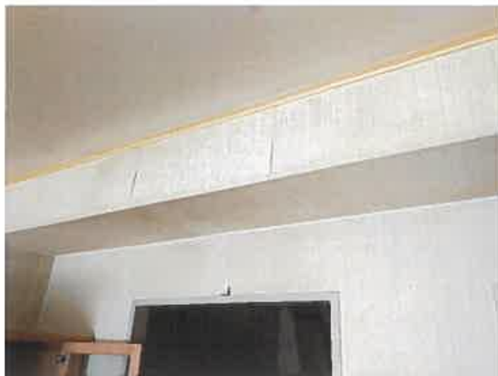
天井・壁の汚れが著しい
