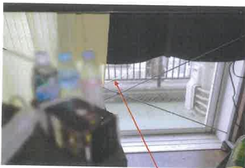
201号室サッシガラス割れ
