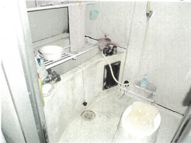
208号室 浴室③⑨の状況
