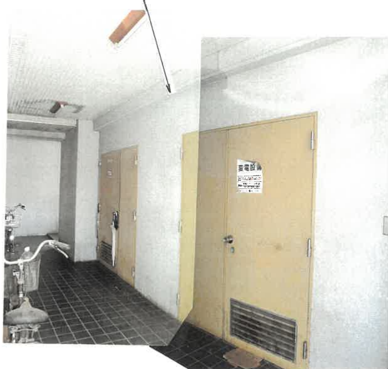
物件4 1階 機械室・変電室
