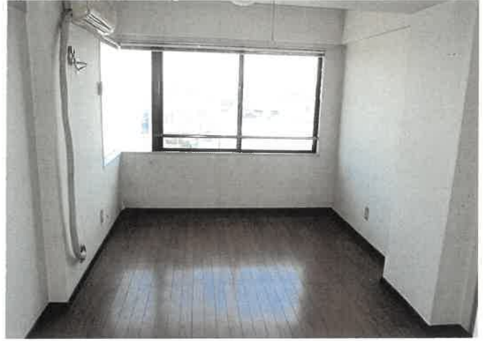
402号線 洋室の状況 ⑦③
