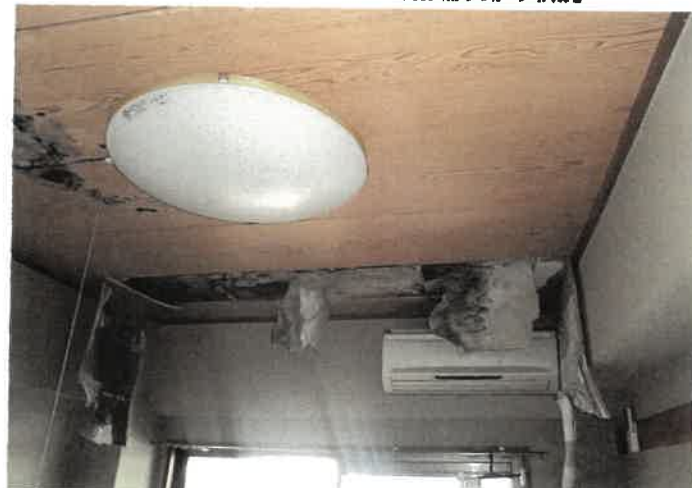
402号室 洋室 天井雨漏り跡の状況
