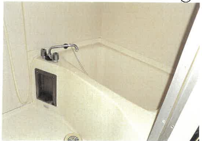
302号室 浴室の状況 ④8
