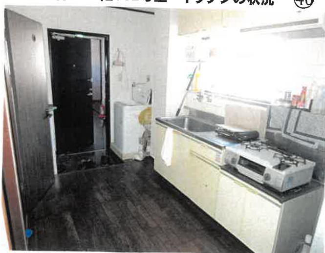
物件4 5階502号室 キッチンの状況 ④⑩
