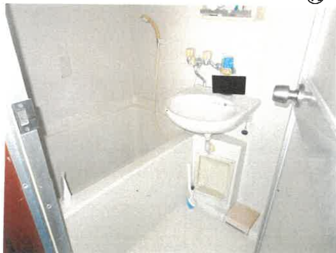
物件4 5階502号室 浴室の状況 ④①
