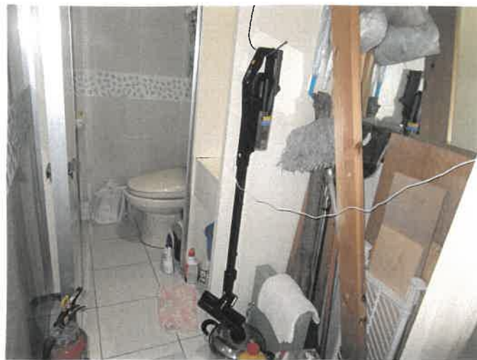
物件4 2階部分トイレ付近の状況
