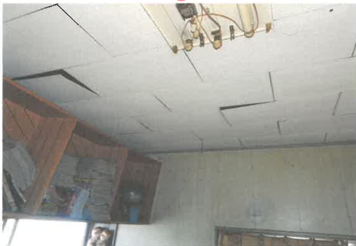
2階洋室の天井の状況
