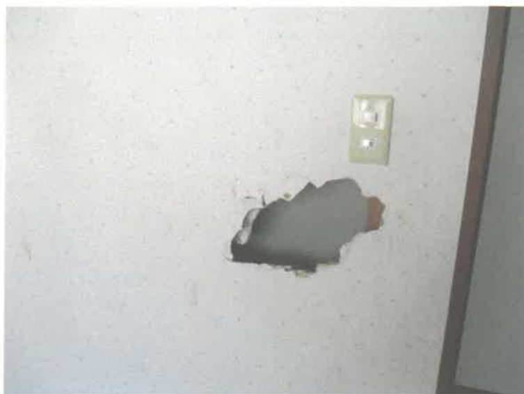
写真 1 0 （1階中央洋室破損箇所）
