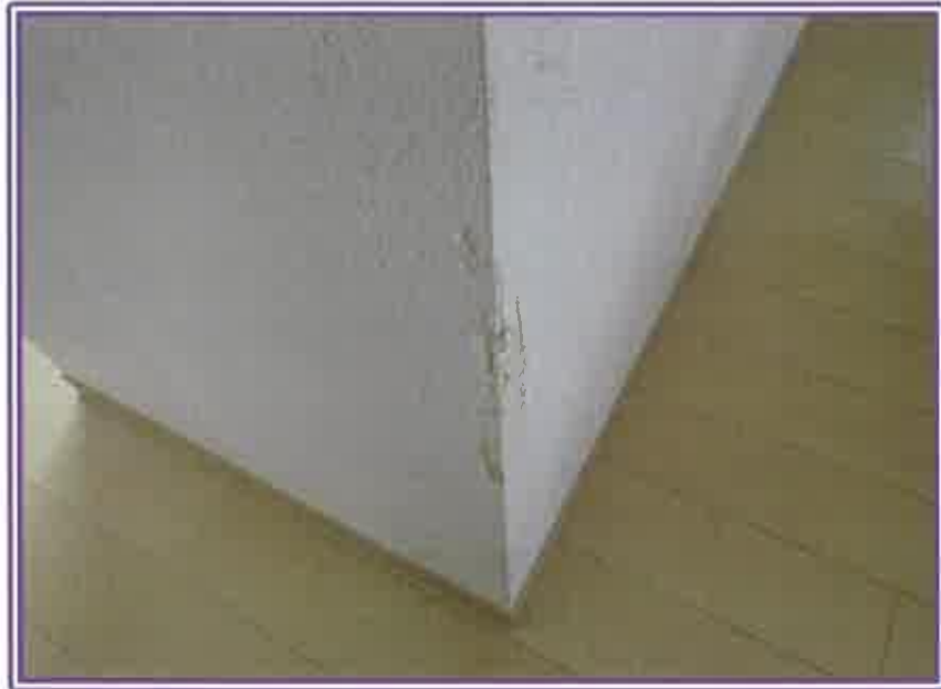
クロスの損傷箇所
