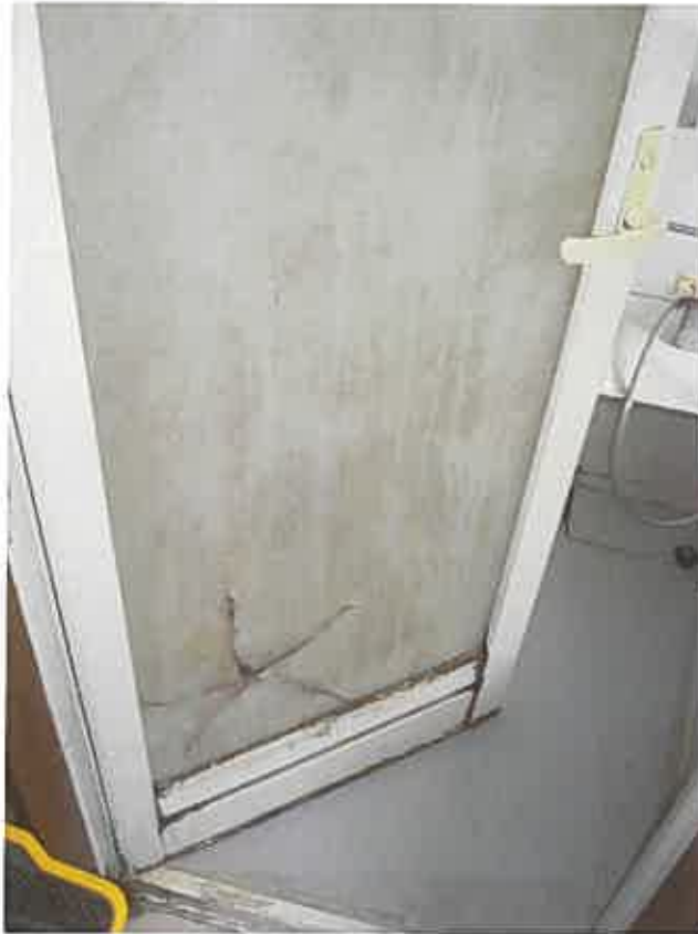
浴槽ドア破損箇所
