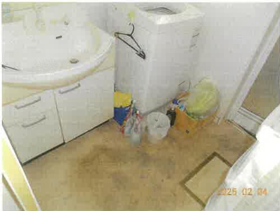
写真 8 本件建物 1 階洗面脱衣の床の水漏れ跡
