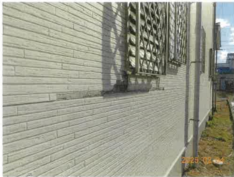
写真5 本件建物の外壁部分の損傷箇所（撮影位置の図示は省略）
