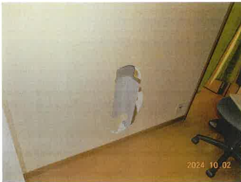
写真13 本件建物1階階段前の内壁の破損箇所（壁穴）
