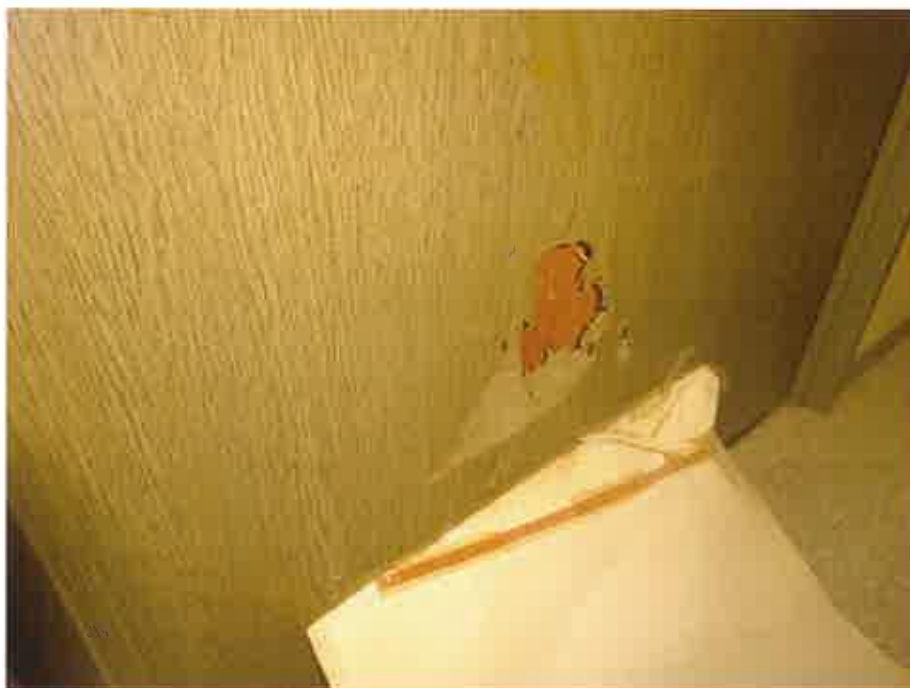
(7) 洋室ドア板の破損
