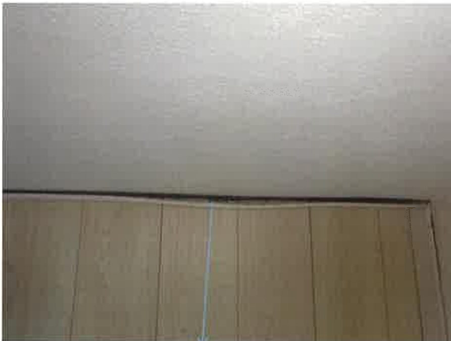
内壁縁の破損
