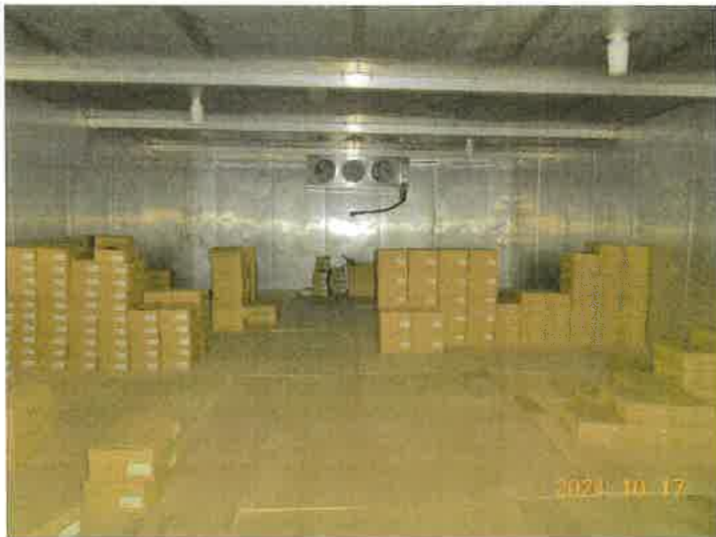
写真 3 0 写真 2 9 の冷蔵倉庫内
