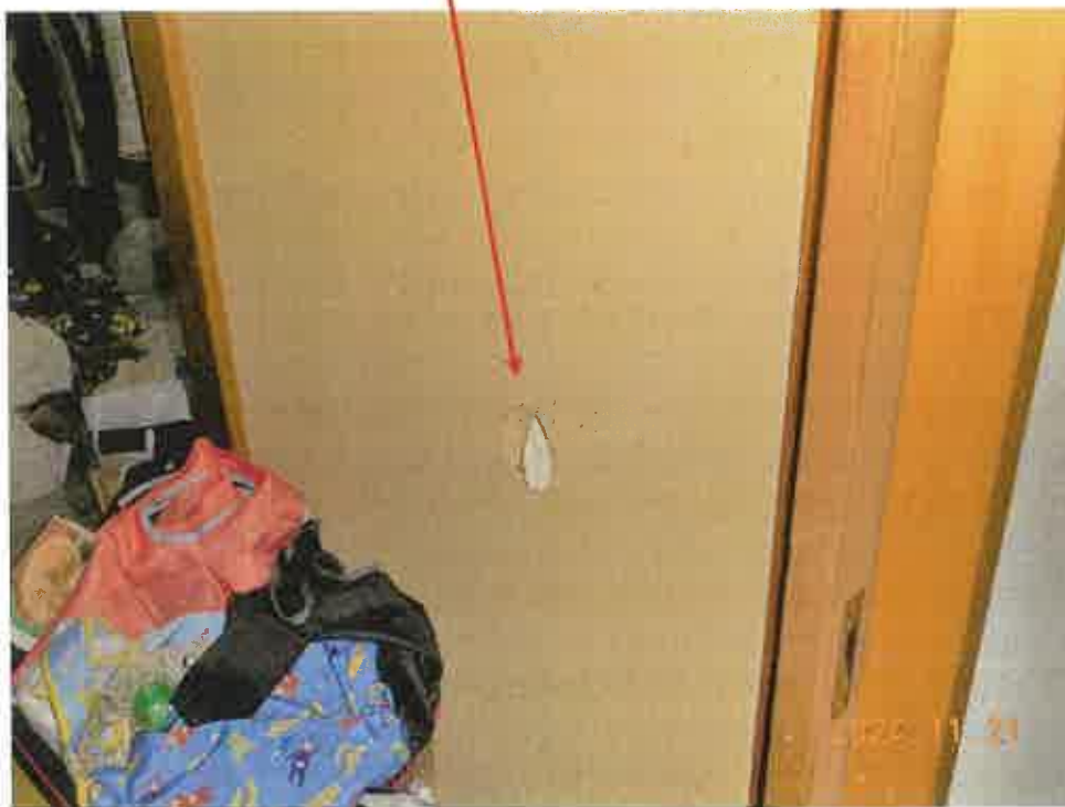
写真 1 5 本件建物 1 階食堂付近の内壁部分の凹み箇所
