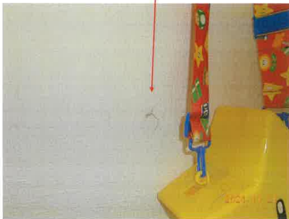
写真13 本件建物1階居間の内壁部分の凹み箇所
