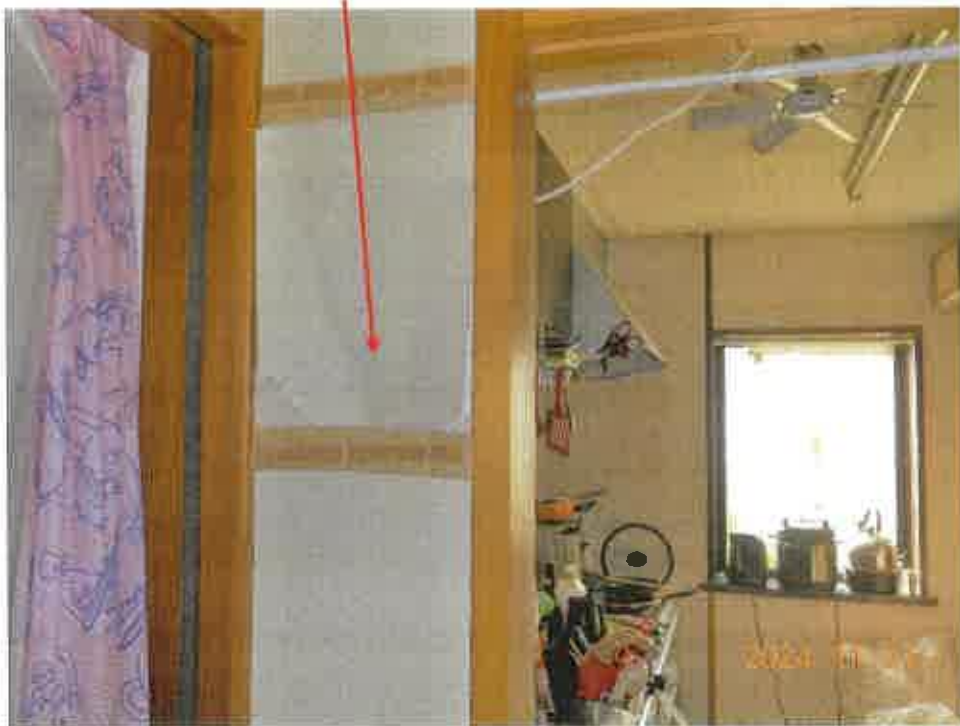
写真9 本件建物1階台所付近の内壁部分の凹み箇所
