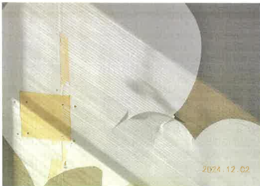
写真 2 4 上記写真 2 3（本件建物 2 階南側洋室）の内壁の凹み箇所等 （撮影位置の図示は省略）
