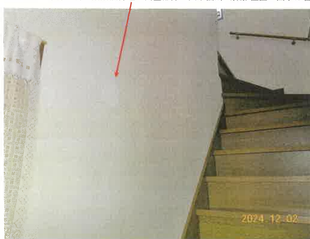
写真 1 8 本件建物 1 階階段付近の内壁部分の凹み箇所（撮影位置の図示は省略）
