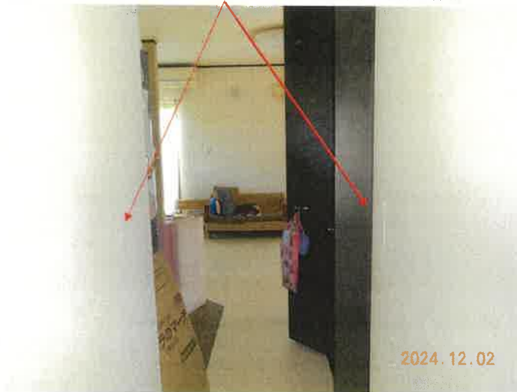
写真 2 5 本件建物 2 階廊下の内壁の凹み箇所（撮影位置の図示は省略）
