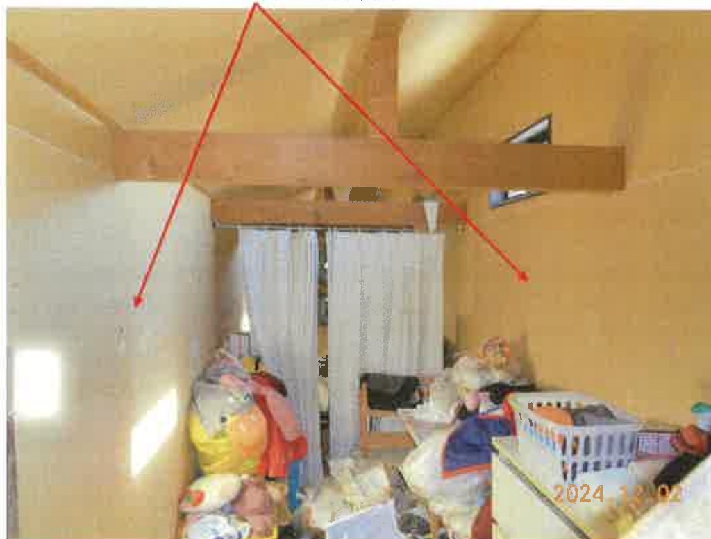
写真 3 1 屋根裏スペースの内壁の凹み箇所
