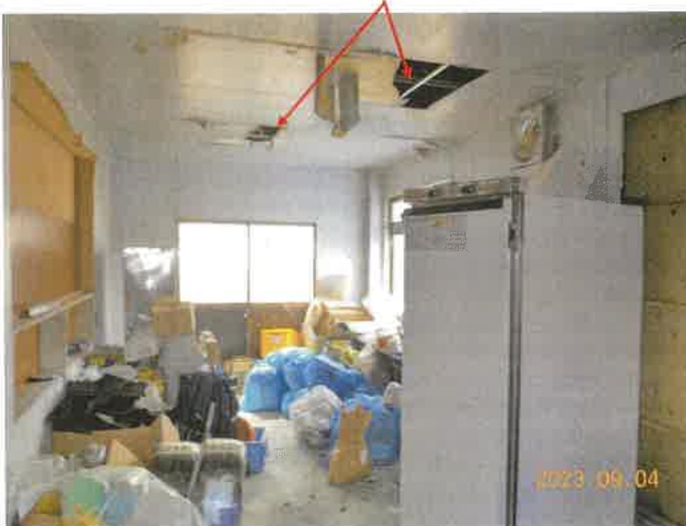
写真 1 1 本件建物 1 階南西側店舗内の天井部分の破損箇所
