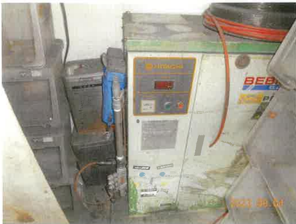
写真9 パッケージコンプレッサー
