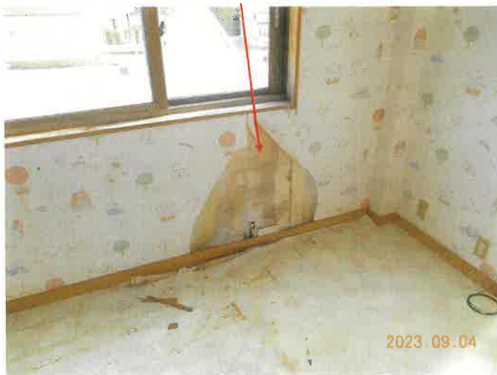
写真 2 1 本件建物 2 階北東側洋室内の雨漏り跡等の損傷箇所
