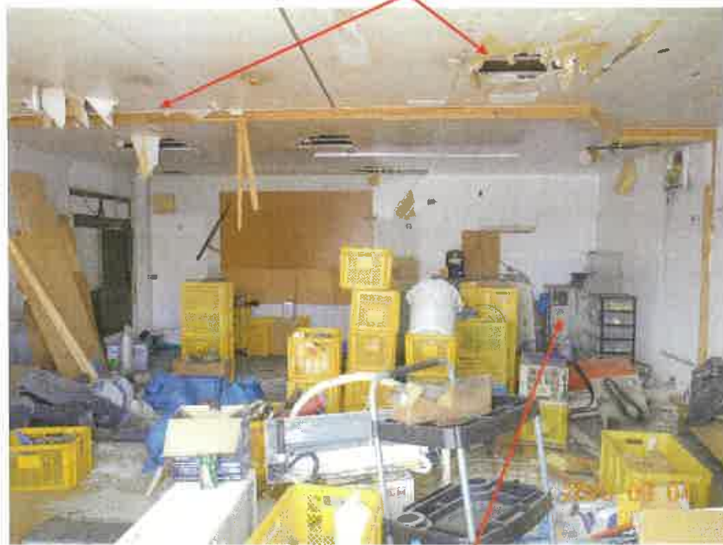
パッケージコンプレッサー（写真9参照）
