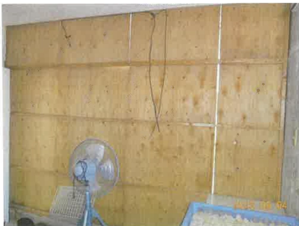
写真 1 2 本件建物 1 階西側の一部取壊し箇所
