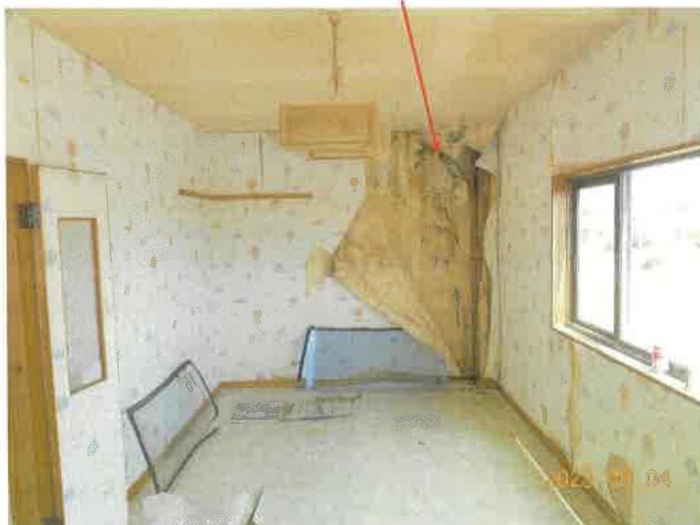
写真 2 0 本件建物 2 階北東側洋室内の雨漏り跡等の損傷箇所
