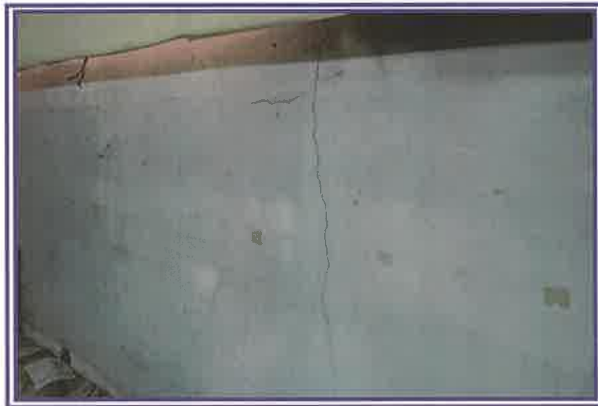
壁に亀裂が認められる状況を撮影したもの(1階店舗)
