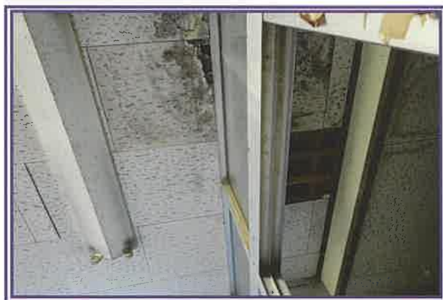
天井板が損傷している状況を撮影したもの(1階店舗, 台所)
