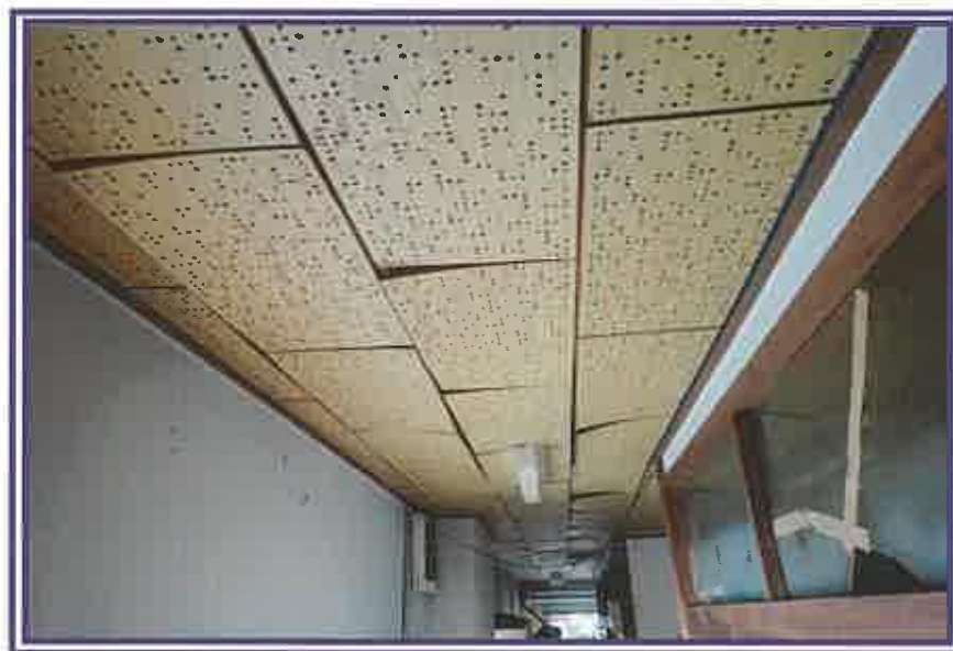
天井板に歪みが認められる状況を撮影したもの(2階廊下)
