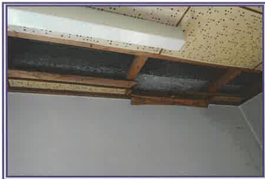
天井板の損傷が認められる状況を撮影したもの(2階廊下)
