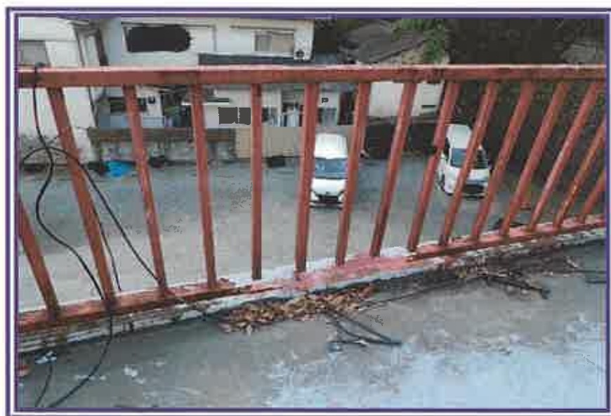
フェンスに損傷が認められる状況を撮影したもの(屋上)
