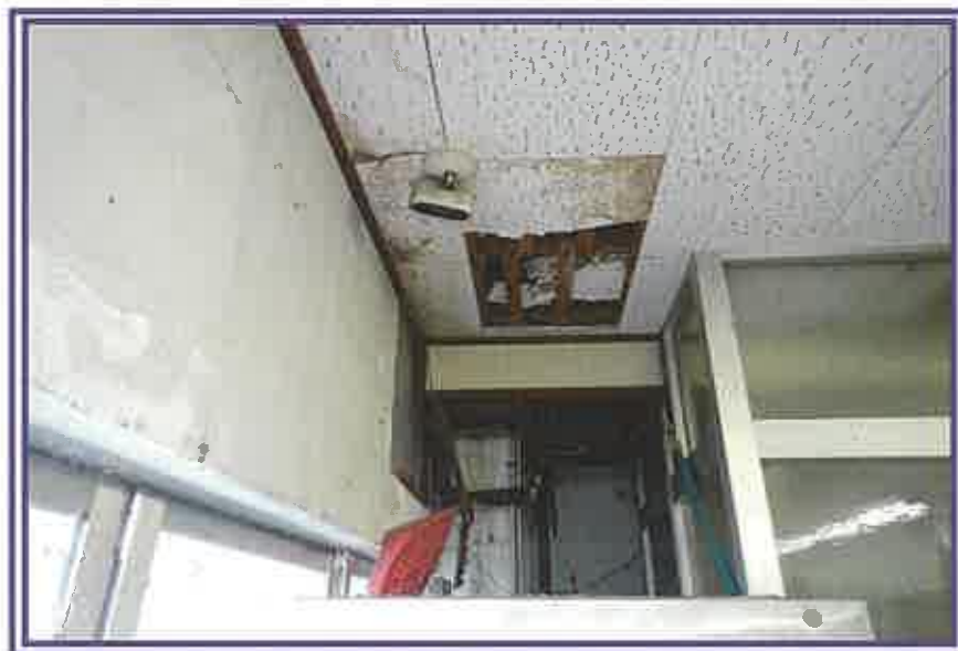
天井板が損傷している状況を撮影したもの(1階店舗)
