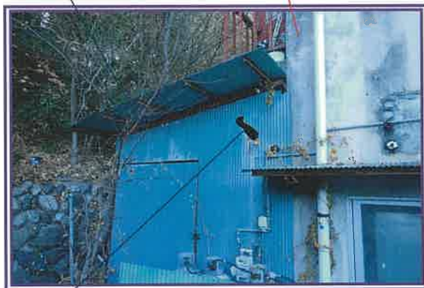
壁の損傷箇所
