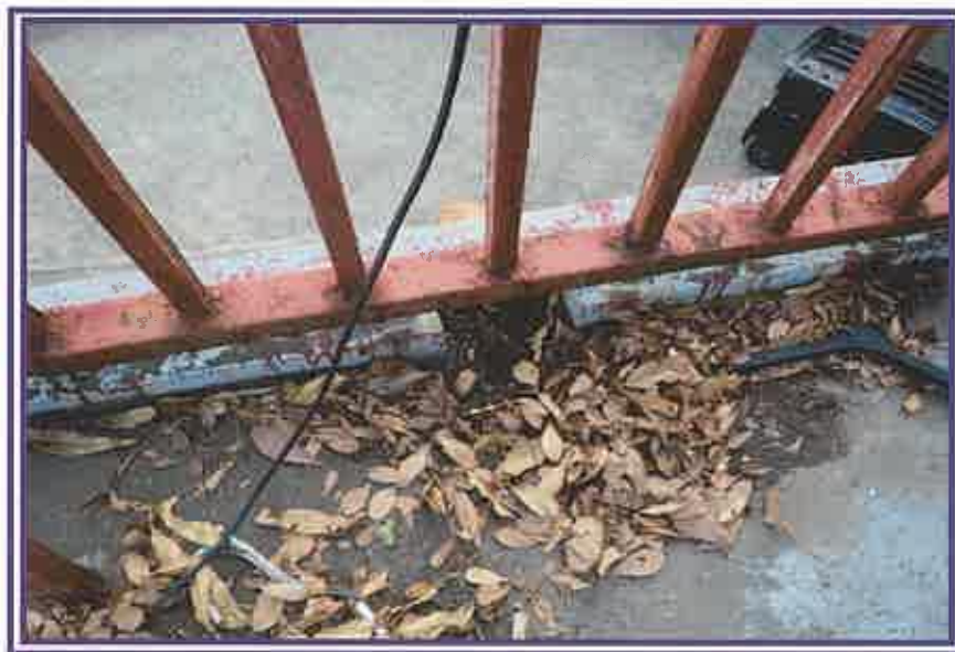
排水口の周辺に、落葉や砂などが堆積している状況を撮影したもの(屋上)
