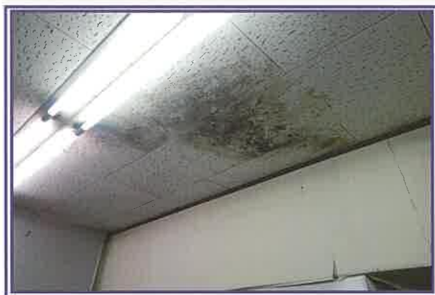
雨漏り跡が認められる状況を撮影したもの(1階店舗)
