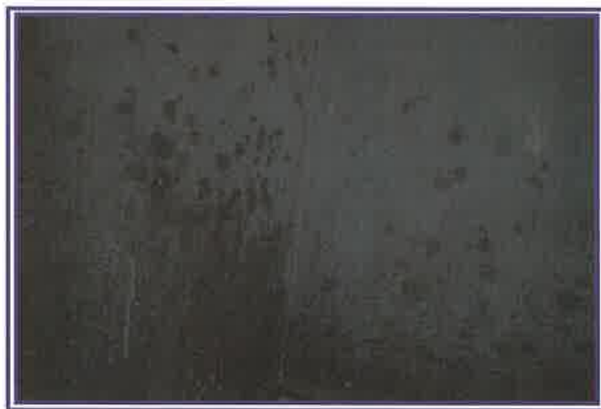
壁にカビが認められる状況を撮影したもの(2階浴室)
