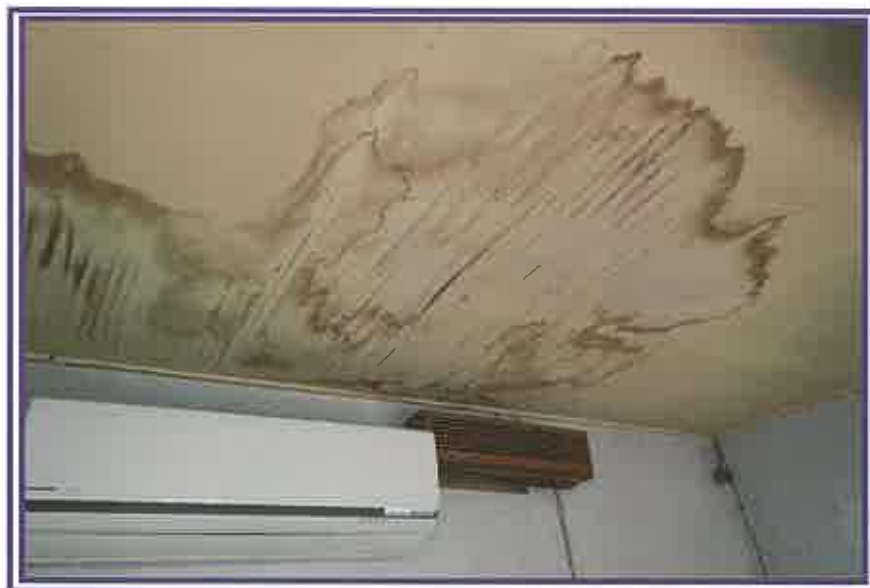
天井の雨漏り跡を撮影したもの(洋室2, 物件4)
