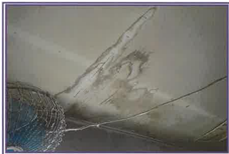
天井の雨漏り跡を撮影したもの(和室3, 物件4)
