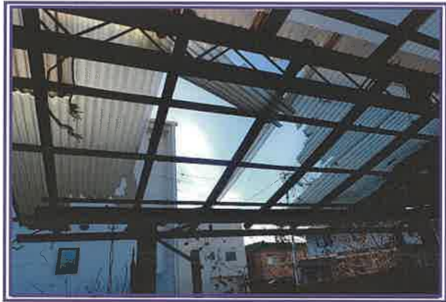
下屋の屋根の損傷箇所を撮影したもの
