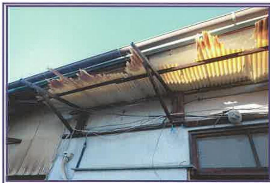
底の損傷箇所を撮影したもの(物件4)
