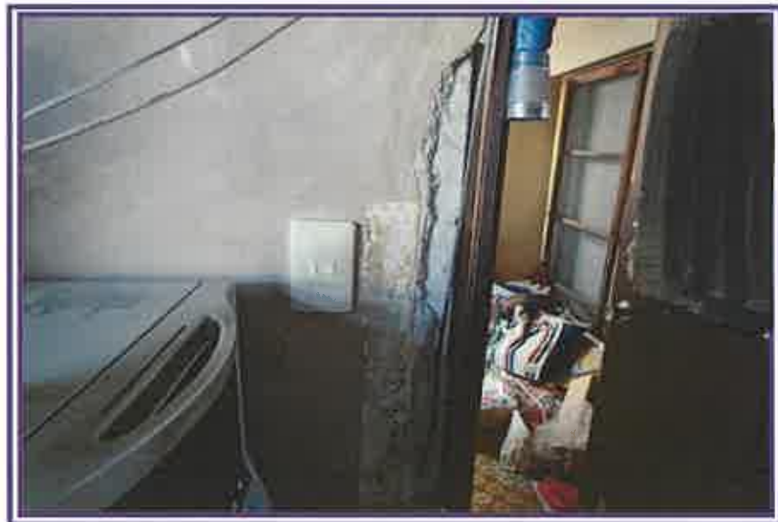
台所の壁に損傷が認められる状況を撮影したもの(物件2)
