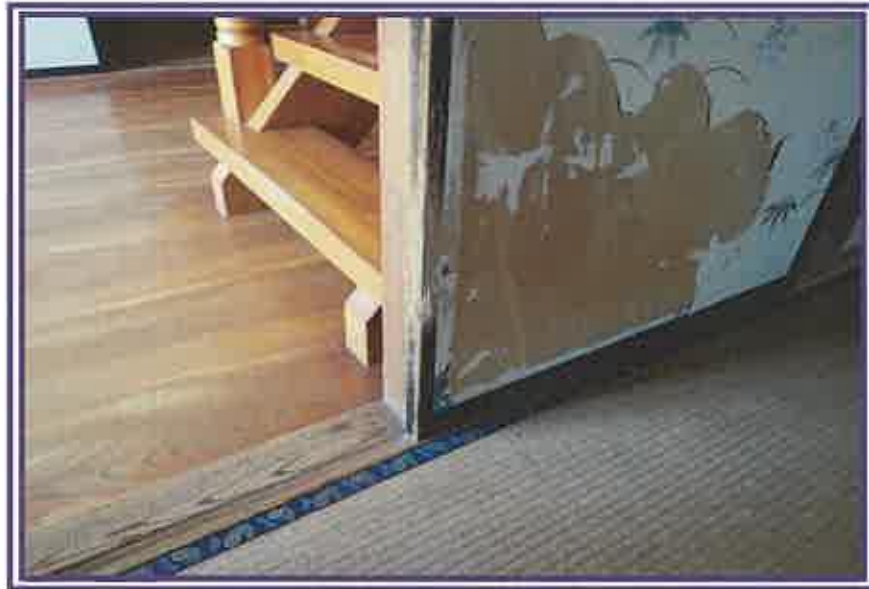
襖に損傷が認められる状況を撮影したもの(物件3主である建物の「和室4」)
