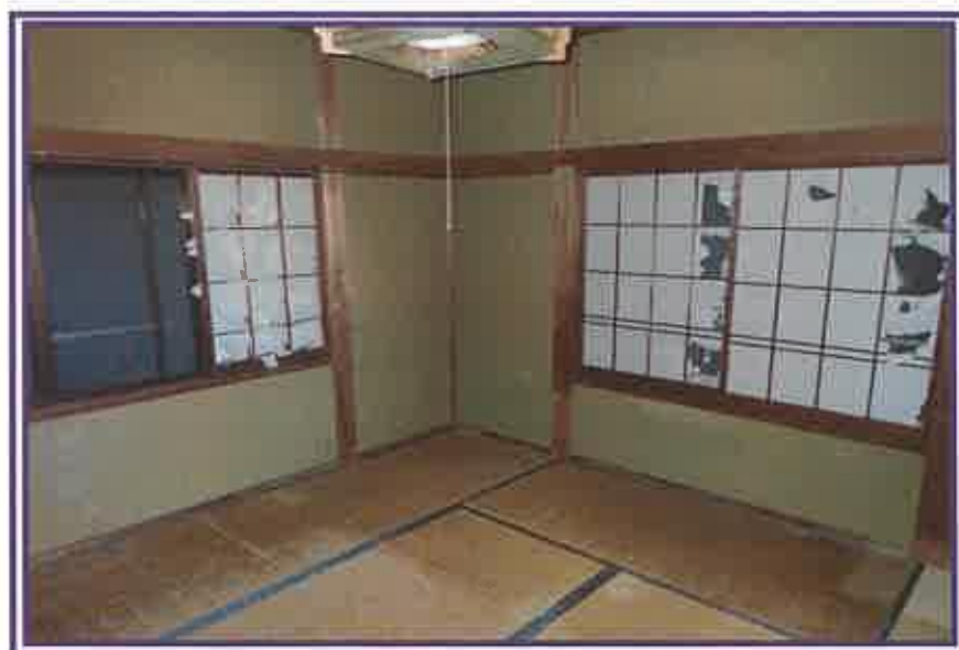
2階居室(間取図中の「和室5」)の障子が破れている状況を撮影したもの (物件3主である建物)
