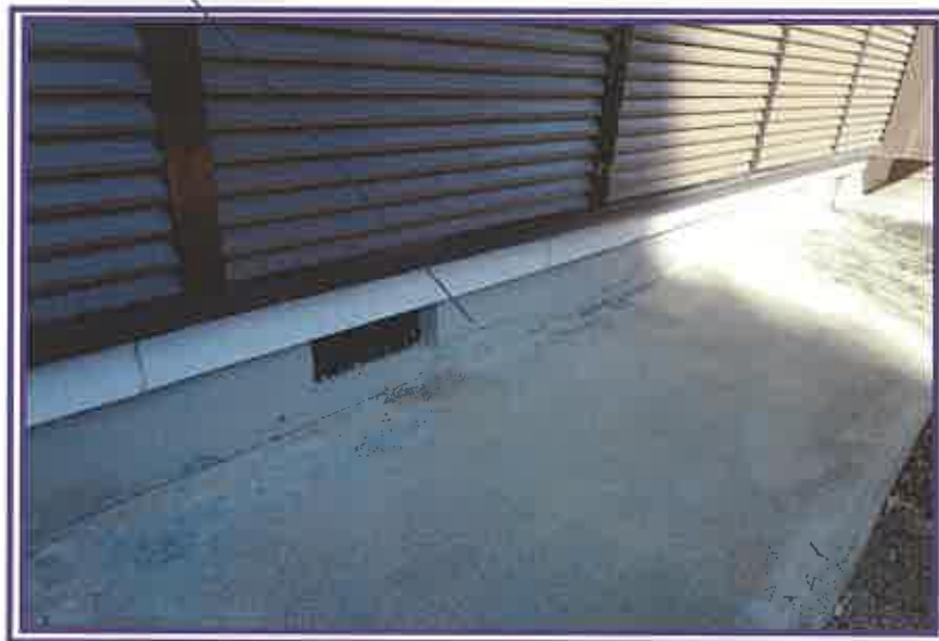
建物の基礎部分に亀裂が認められる状況を撮影したもの(物件3主である建物)
