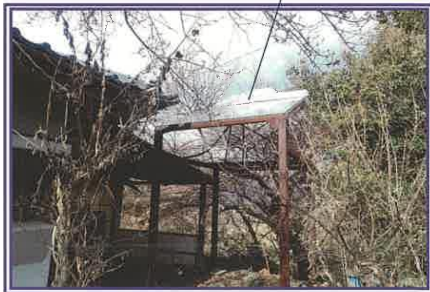
太陽光温水器及びその土台(構築物)を撮影したもの
