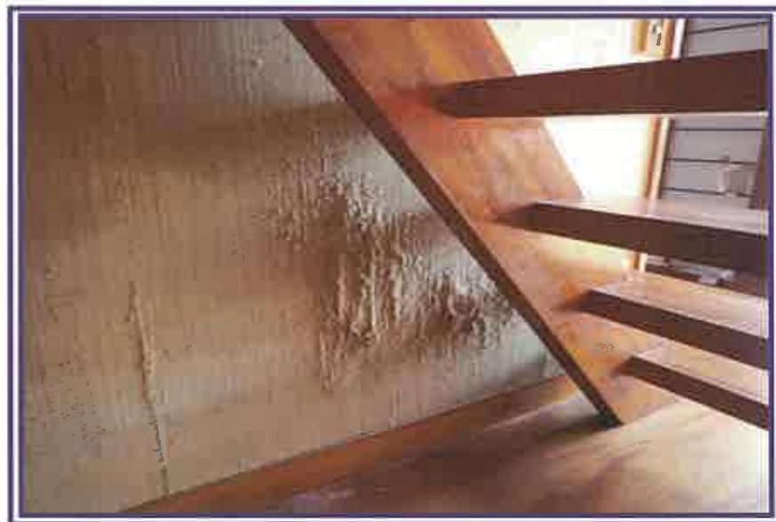
1階階段付近の壁のクロスに損傷が認められる状況を撮影したもの (物件3主である建物)
