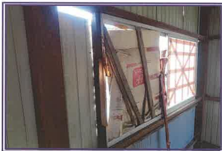
窓ガラスの破損箇所を段ボールで覆っている状況を撮影したもの (物件3附属建物符号1)
