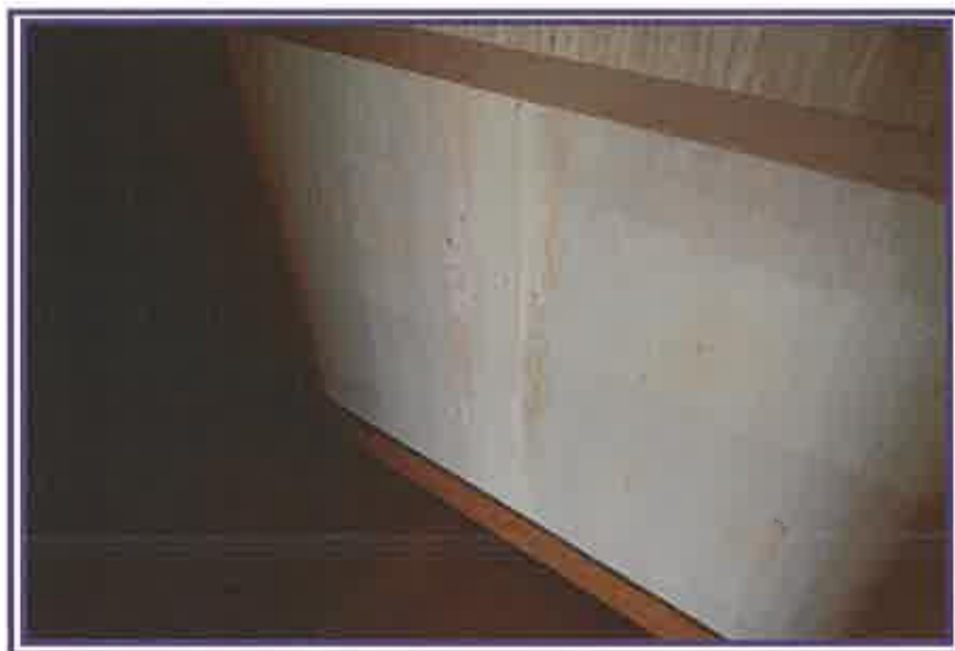
1階廊下の壁のクロスに損傷が認められる状況を撮影したもの (物件3主である建物)
