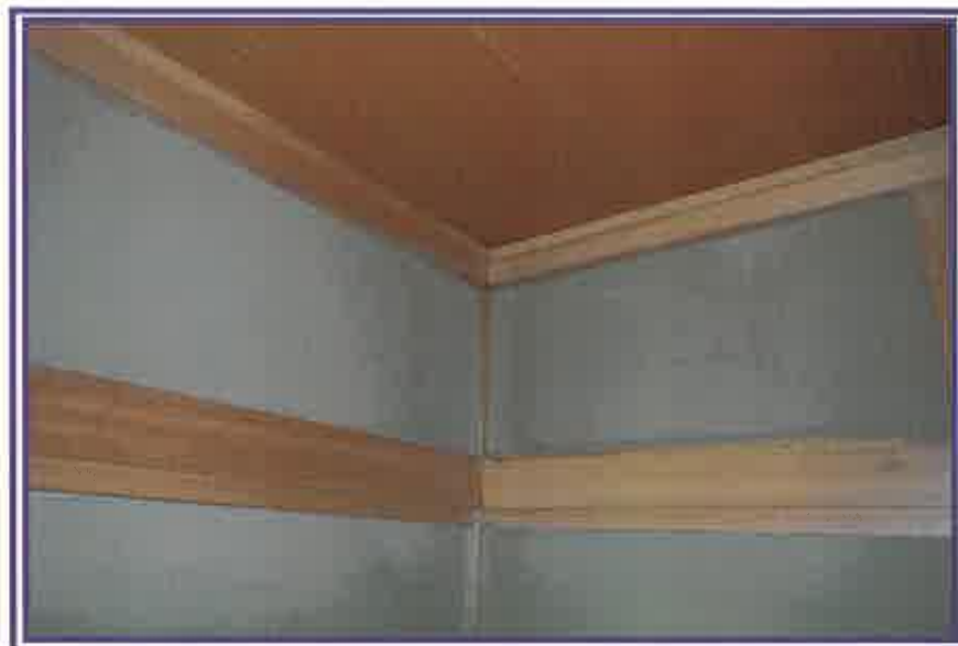
和室1の天井付近に、雨漏り跡が認められる状況を撮影したもの
