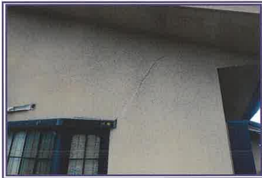
2階外壁に、亀裂が認められる状況を撮影したもの
