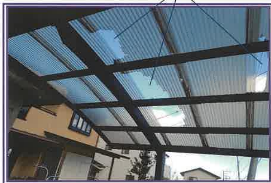
カーポートの屋根が破損している状況を撮影したもの
