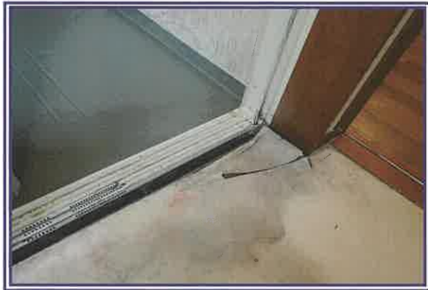
浴室入口付近の、床の腐食箇所を撮影したもの(物件3(住宅))
