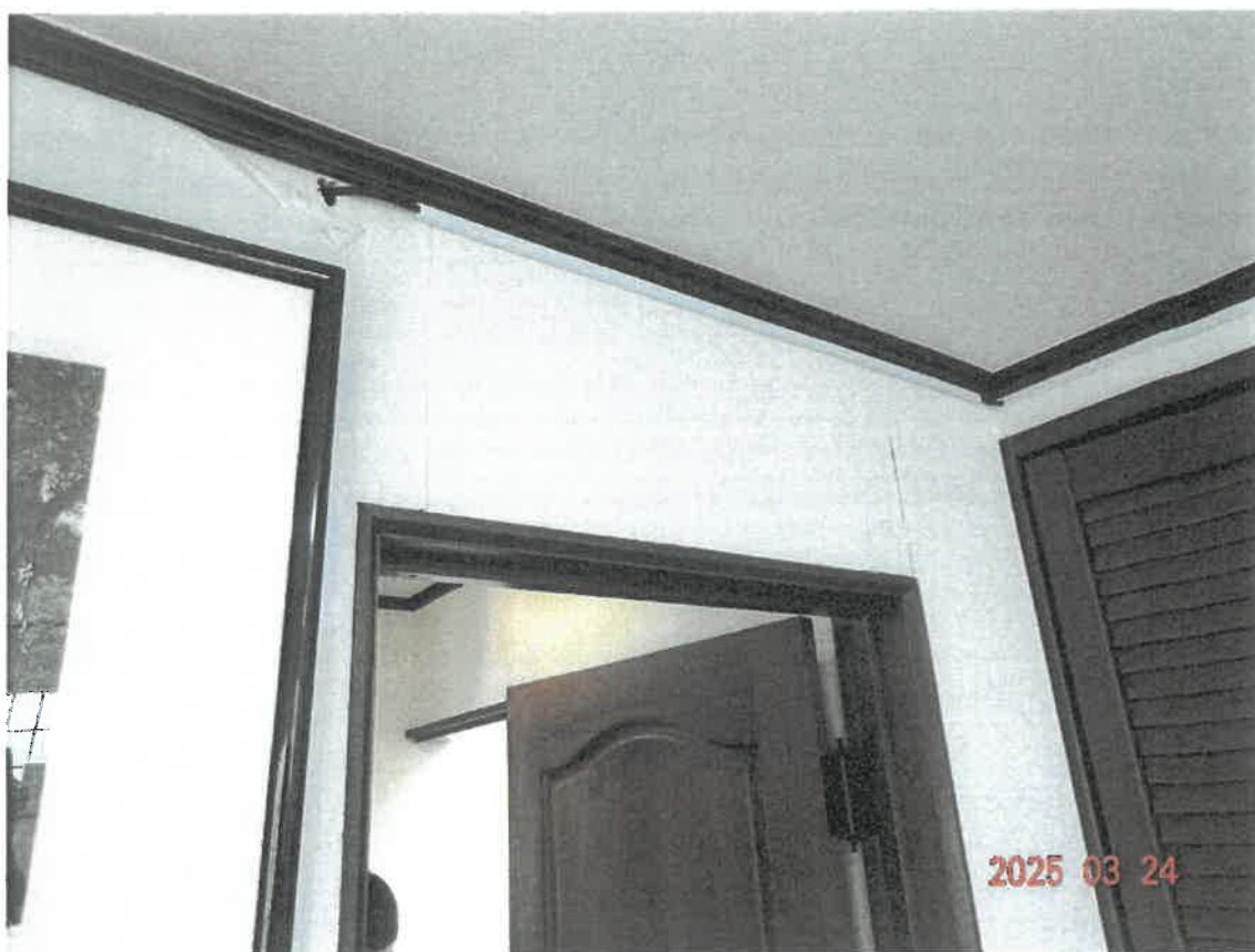
⑪ 3階の壁の損傷
