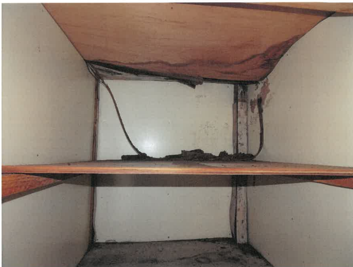
7 一階北西側洋室の物入 [増築部分] (雨漏り跡)
