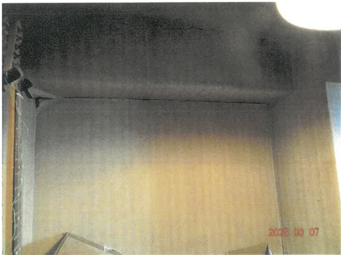
④天井と壁の黒ずみと壁紙のめくれ
