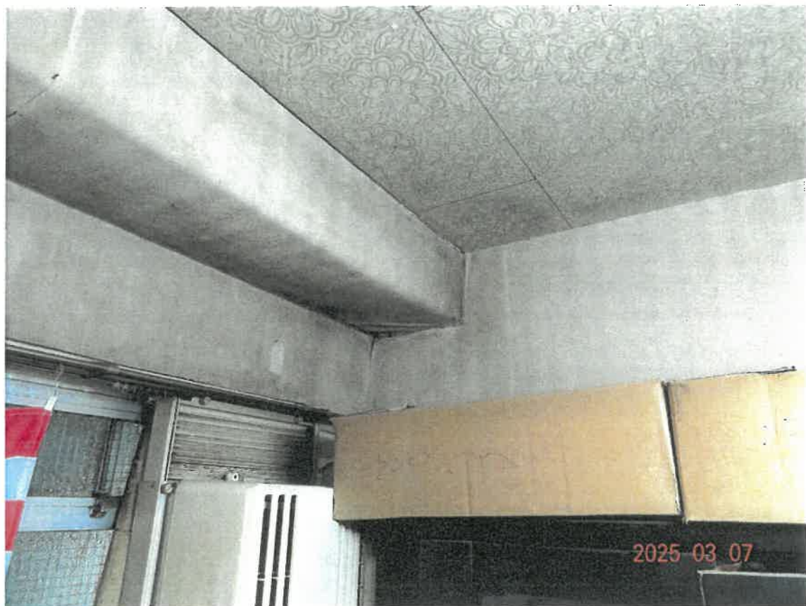
③天井と壁の黒ずみ
