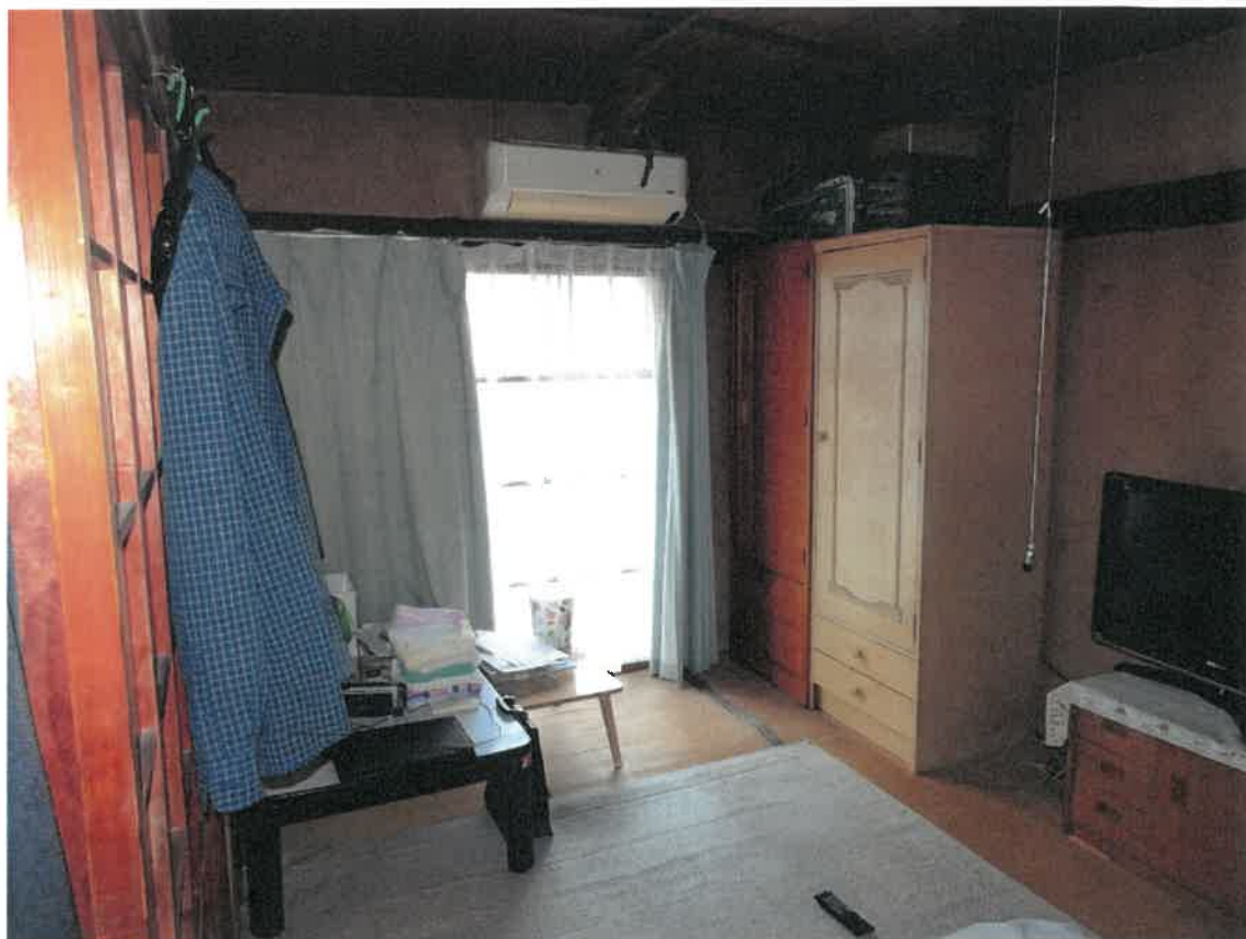
3 雨漏りによる天井の損傷箇所
