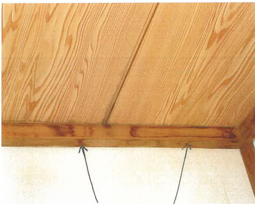
天井と壁の間にある雨漏り跡のようなシミ
