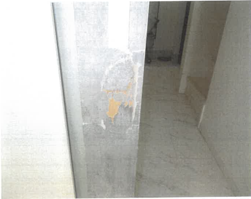
扉にある損傷
