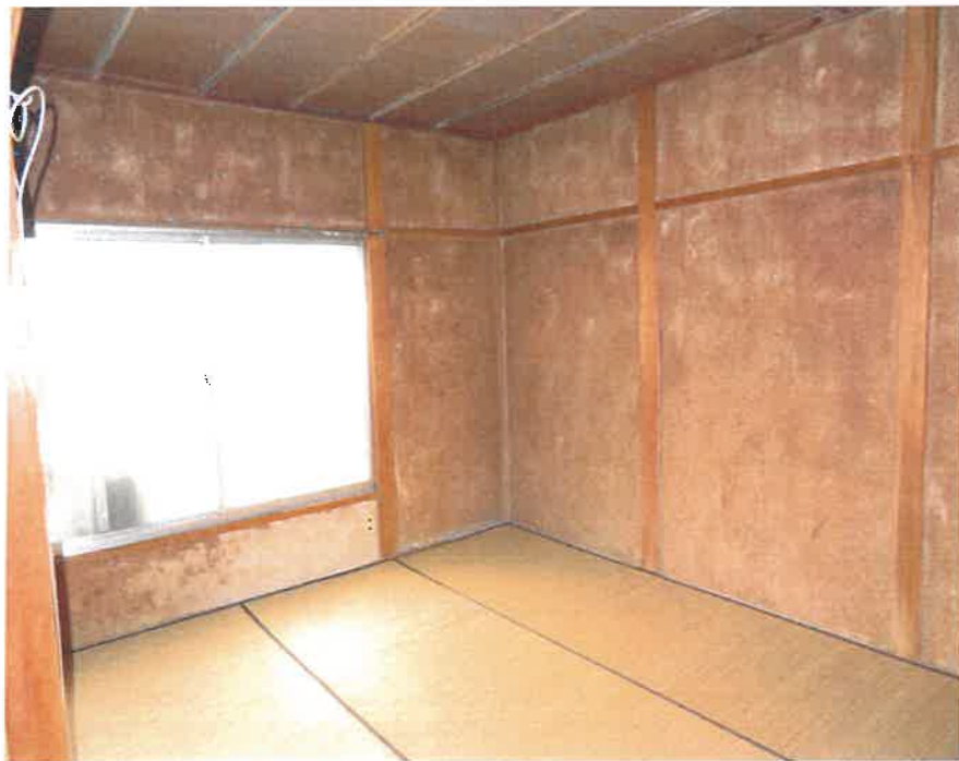
全体的にみられる壁の劣化
