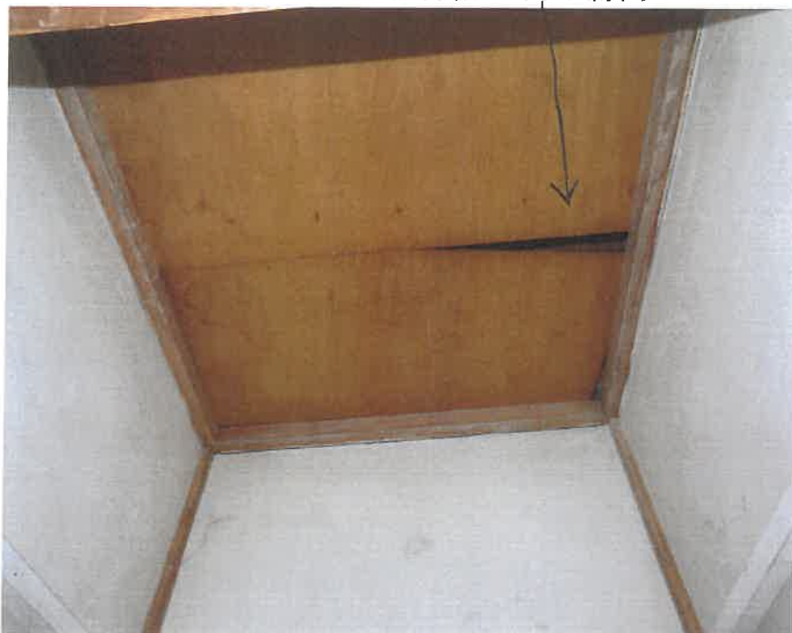
天井板が外れた隙間
