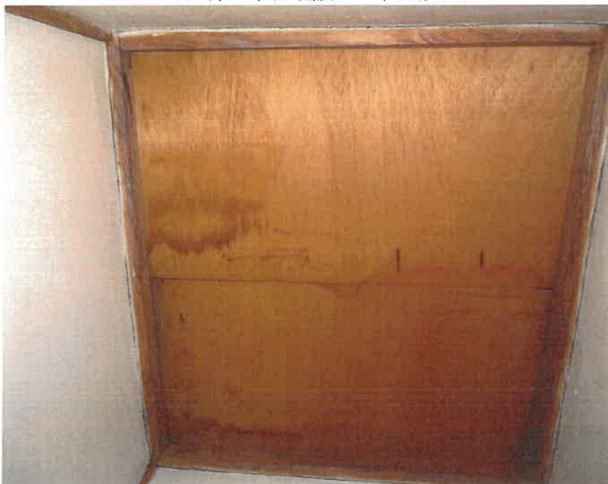
天井にある雨漏りのような跡
