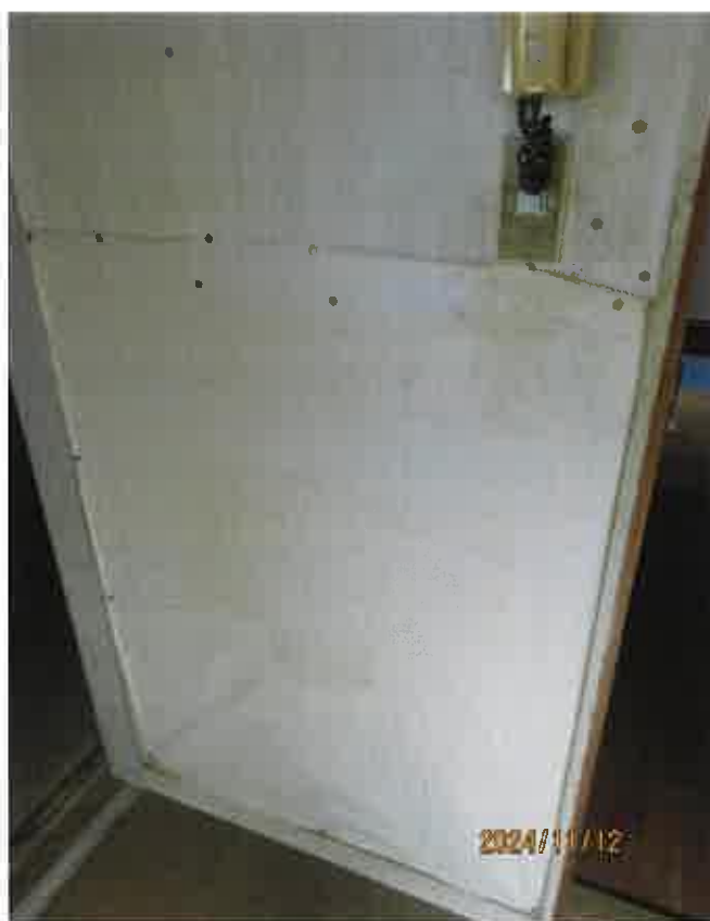
内壁の損傷と思われる部分
