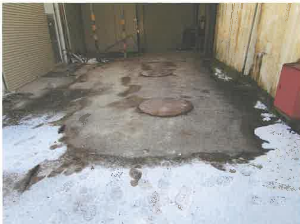
地下貯蔵タンク
