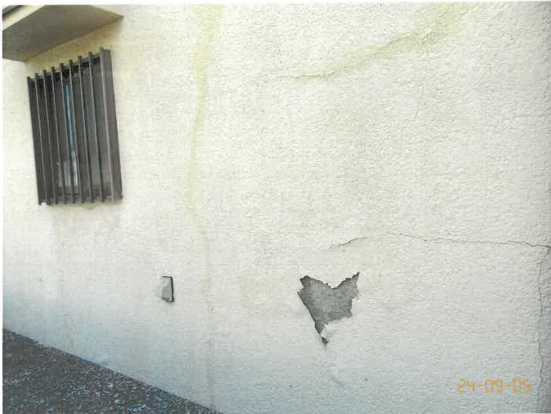
外壁にクラック及び損壊あり
