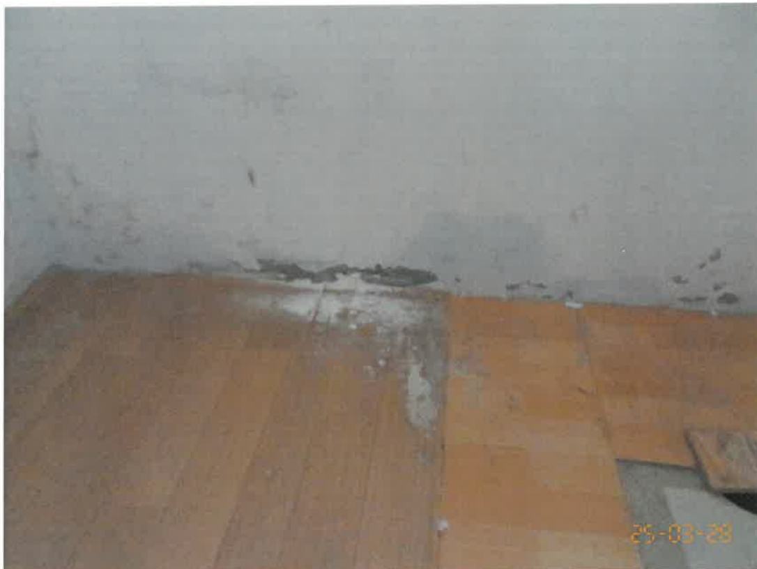
洗面の床の損傷状況
