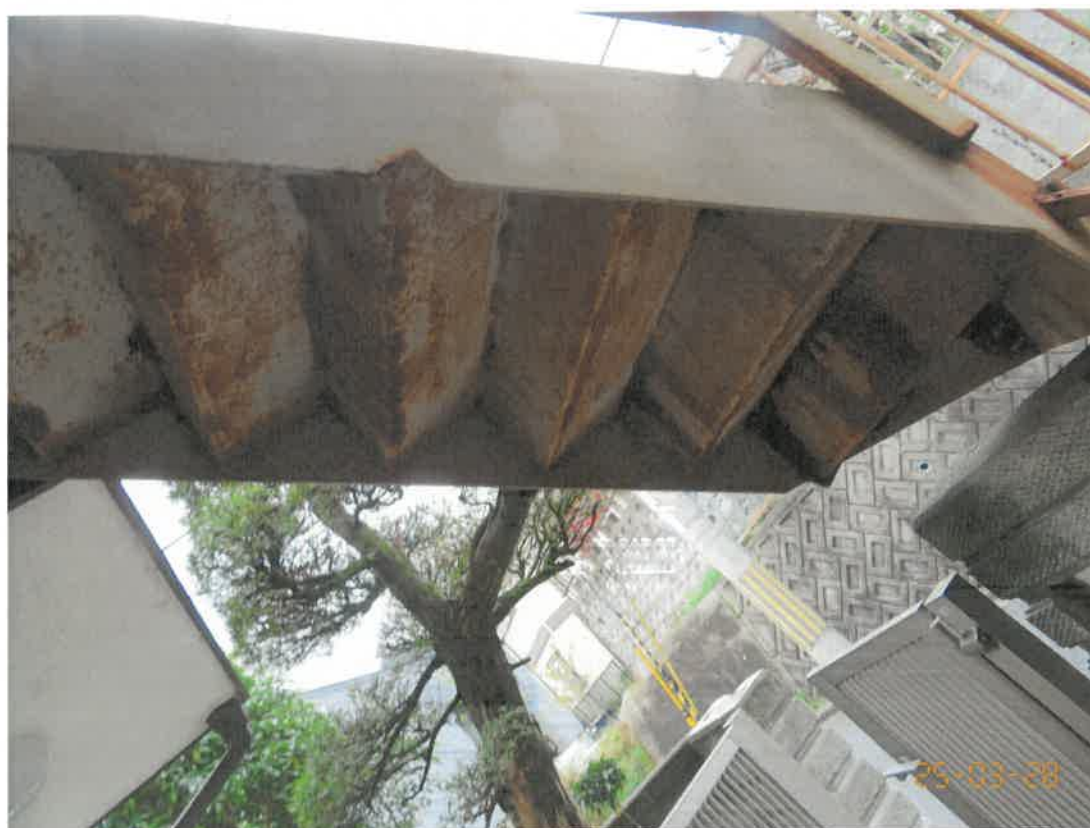
外階段の錆の状況
