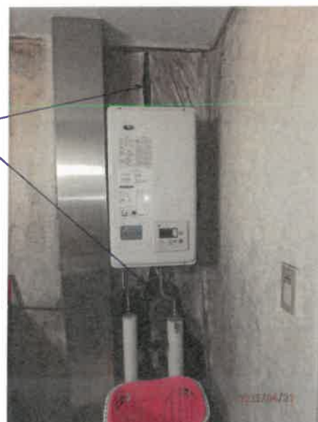
クロスの剥離・汚損
